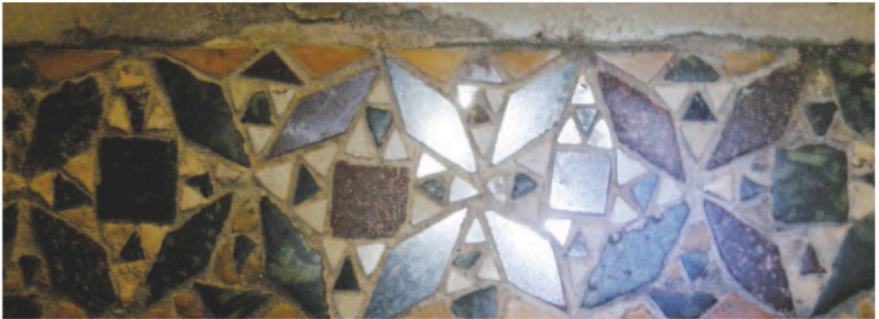
Fig. 42 – Monreale, duomo, navata destra. Particolare del restauro del pavimento eseguito con materiali non pertinenti.
