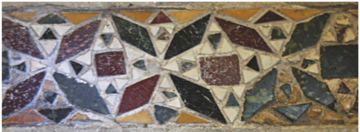
Fig. 43 – Monreale, duomo, navata destra. Particolare del restauro del pavimento eseguito con materiali non pertinenti.
