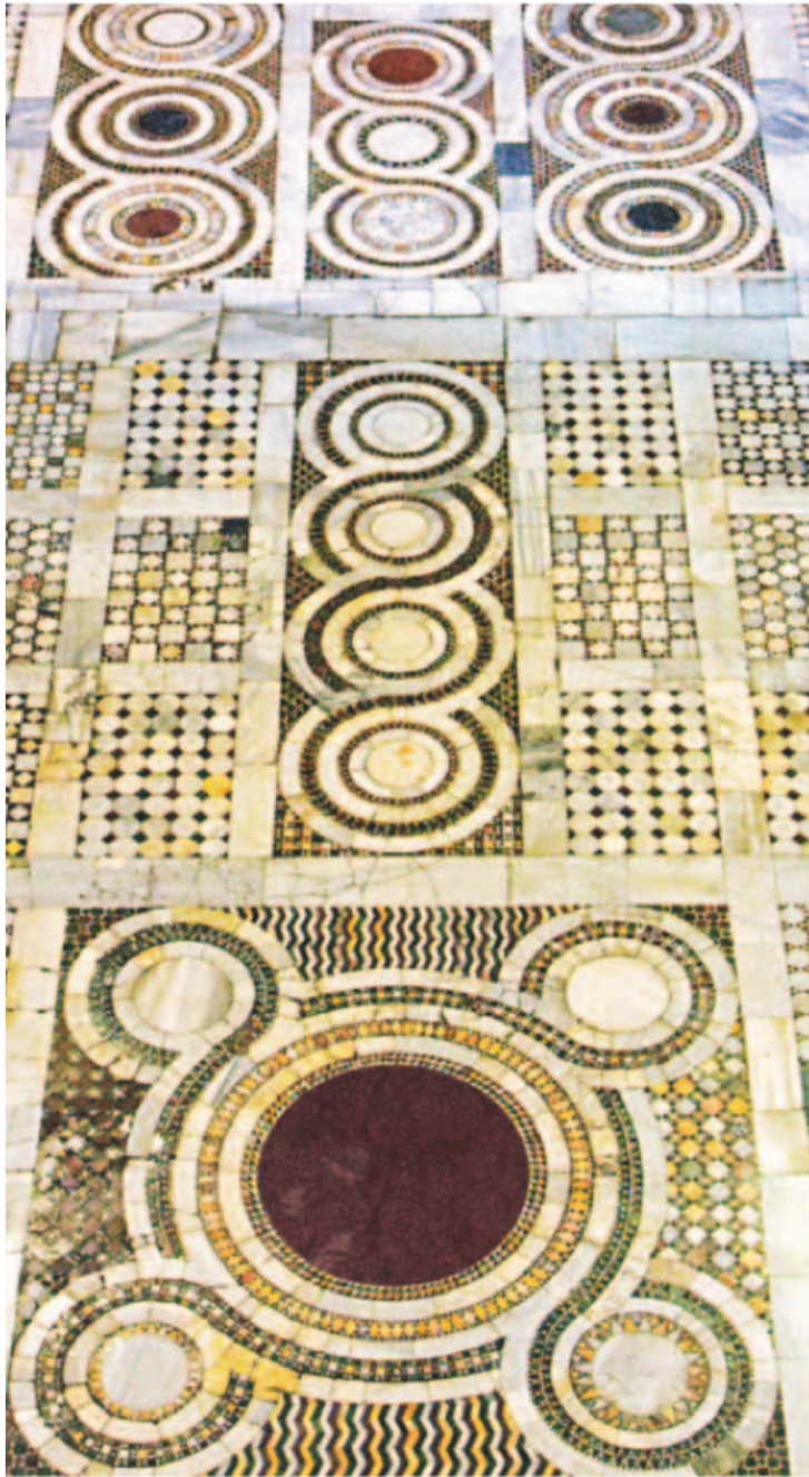
Fig. 46 – Roma. Santi Quattro Coronati, navata centrale. Rotae minori del quincunx ed altre rotae sostituite impropriamente con marmi bianchi.
